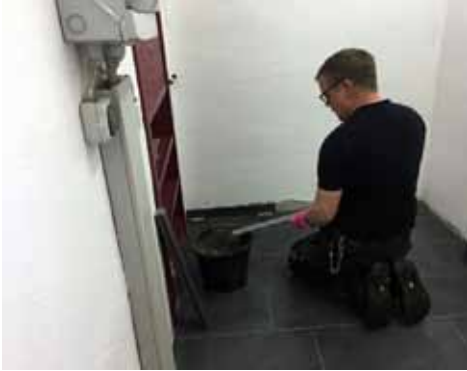
Die Bodenfliesen im Kabäuschen sind verlegt und verfugt. Streuer bringt noch die Fliesenkante an.
